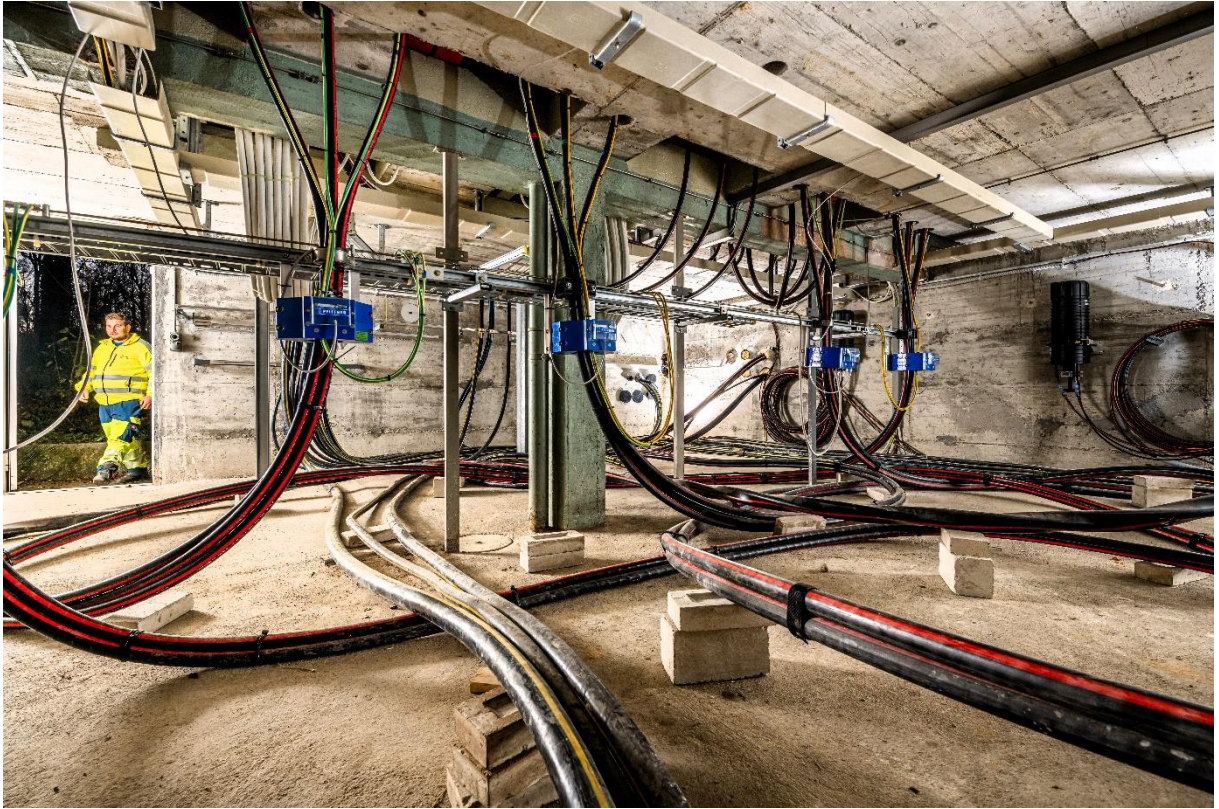
Kabelkeller Trafostation Allmend, Haupteinspeisestation / Foto: Gemeindewerke Villmergen
