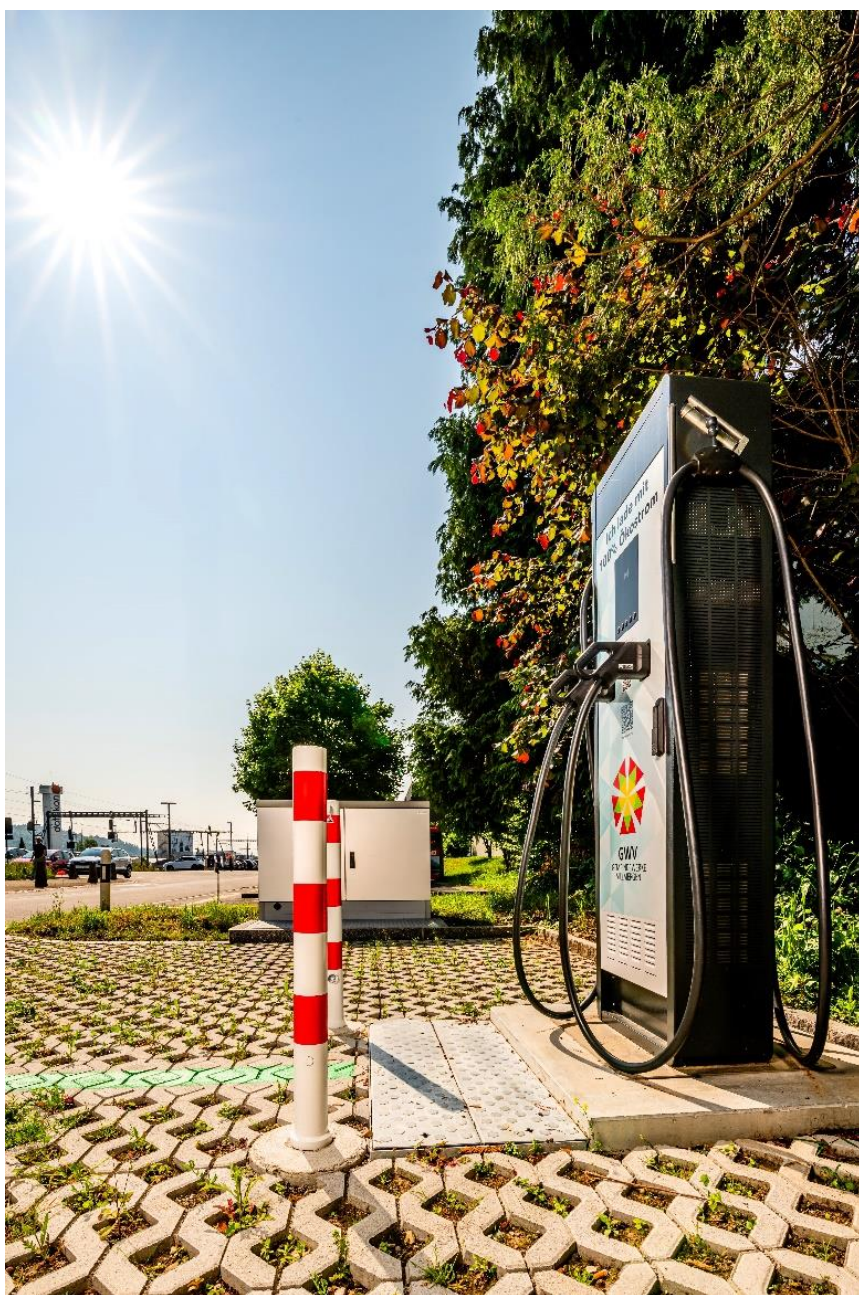
Schnellladestation Bahnhof, Ballygebiet / Foto: Gemeindewerke Villmergen (GWW)
