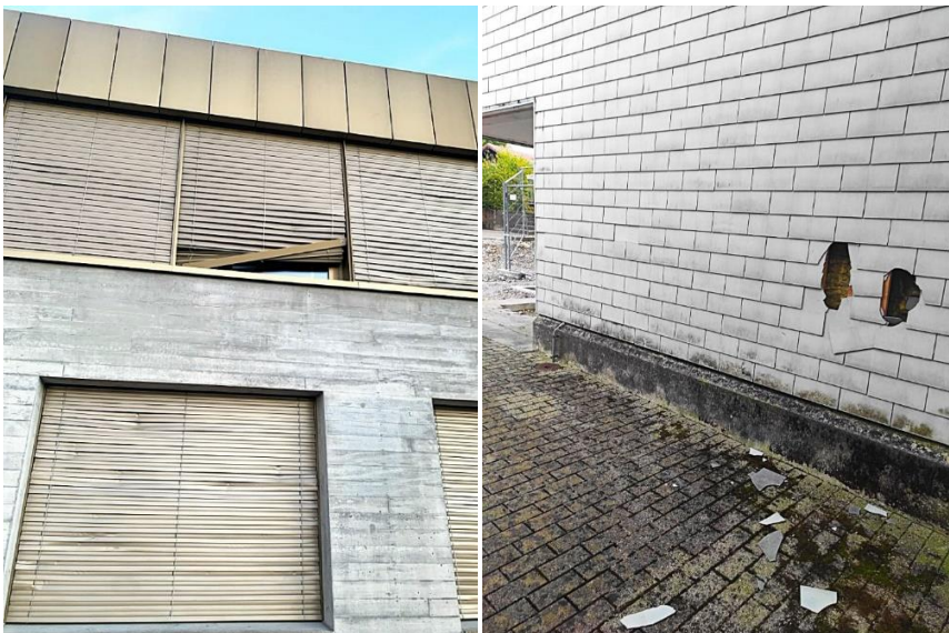
Vandalismus / Fotos: Pampasus Sicherheitsdienst GmbH
