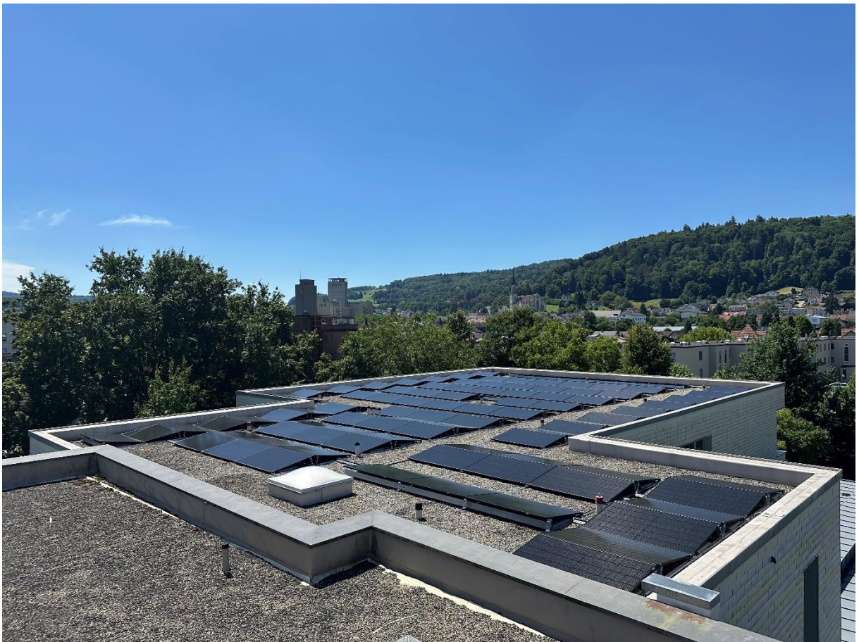
Photovoltaikanlage 2. Etappe / Foto: Bauverwaltung
