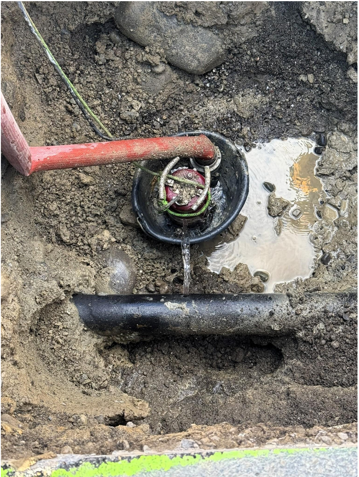
Rohrbruch Rebenstrasse / Foto: Gemeindewerke Villmergen (GWV)
