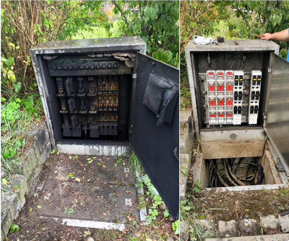
Reparatur des Kurzschlusschadens in der Verteilkabine H09 / Fotos: Gemeindewerke Villmergen (GWV)
