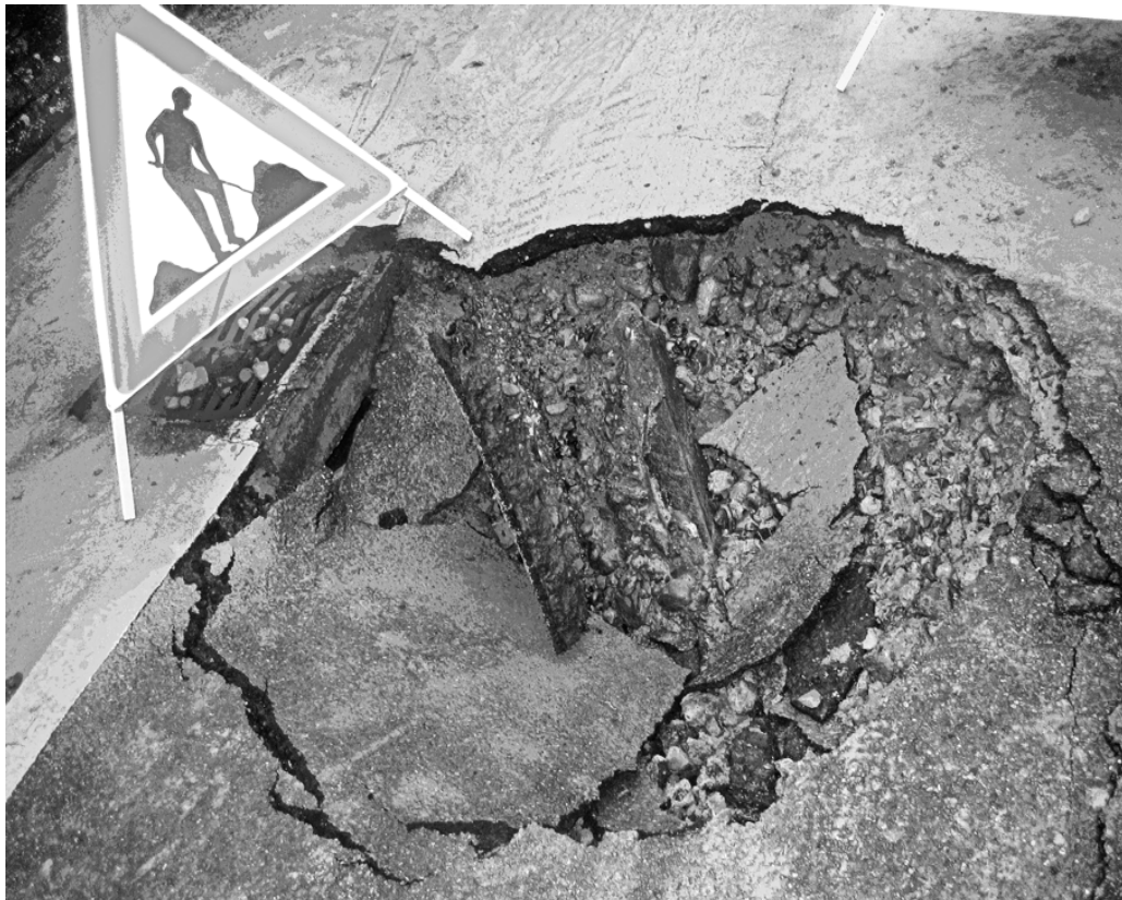
Strassenschaden wegen eines Wasserleitungsbruchs
